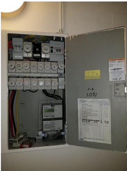
Elektrisk anlegg - [Sikringskap ]
