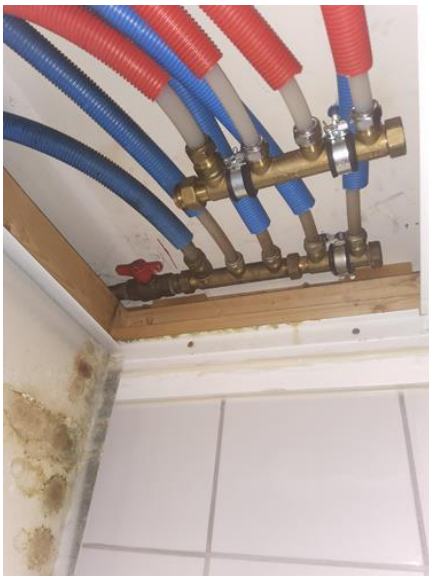
Våtrom - [Fordelesterammer og stoppekran ]
