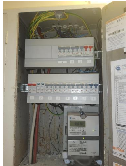
Elektrisk anlegg - [Sikringsskap ]
