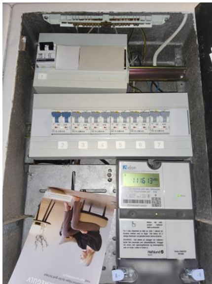
Elektrisk anlegg - [sikringskap]
