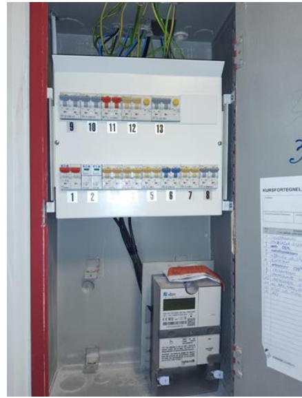
Elektrisk anlegg - [IMG_20240321_133532]
