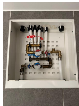
Samleskap med rørkurser og stoppekraner
