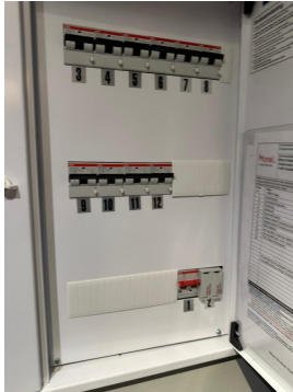
Sikringskap med automatsikringer.
