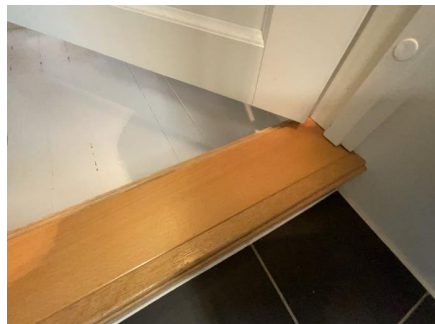
Luftespalte under dørradet.
