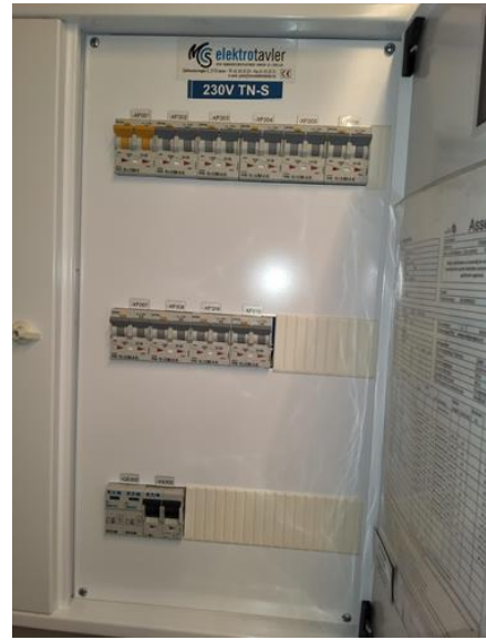
Elektrisk anlegg - [Sikringskap ]
