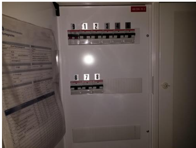
Elektrisk anlegg - [Sikringsskap. ]
