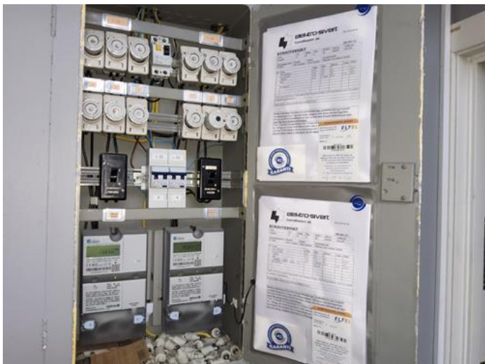
Beskrivelse - [Sikringsskap med kursfortegnelse. ]
