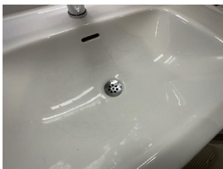
Krakkelering i servant.
