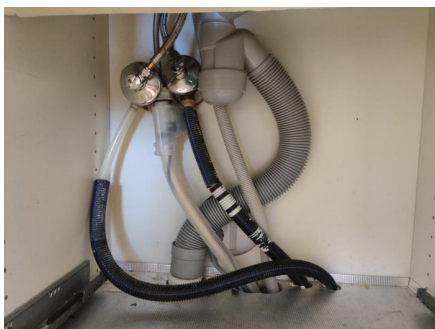
Røropplegg på kjøkken.
