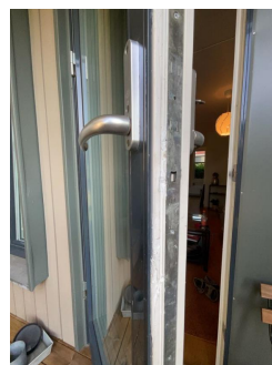
Det er fuget i det aktuelle området som er skadet.
