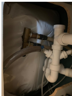
Varmtvannsbereder plassert i hjørneskap på kjøkkenet.
