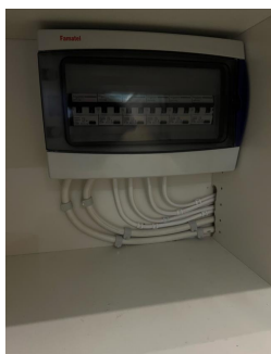
Sikringsskap montert i underskap komfyren på kjøkkenet
