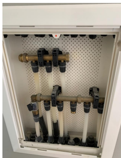
Rørfordelerskap plassert på soverom1 i vegg mot bad/vaskerom.
