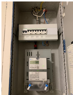
Sikringsskap plassert i felles trappoppgang.
