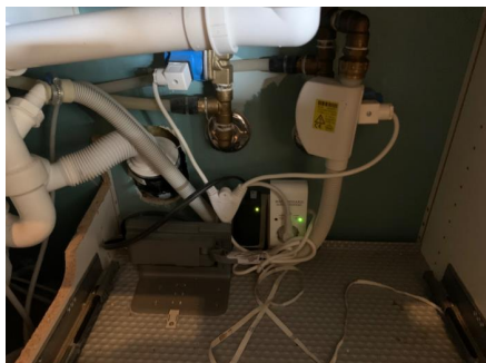
Avløpsrør i underskap vask på kjøkkenet.
