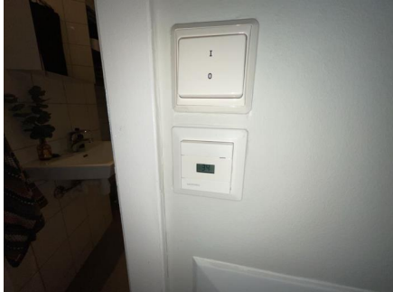
Termostadbryter for varmekabler.
