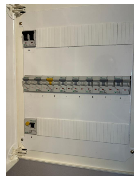
Sikringsskap med automatsikringer.
