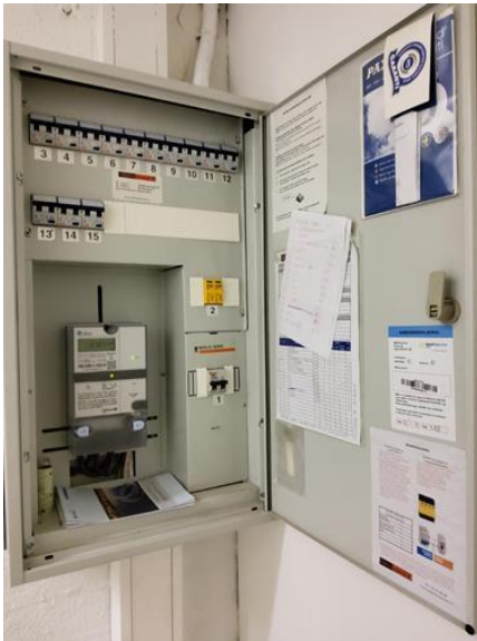
Elektrisk anlegg - [Sikringskap ]
