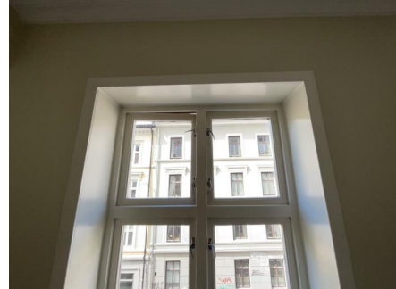
Det er ikke luftespalter i vinduer.
