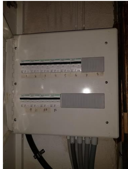
Elektrisk anlegg - [Sikkeringskap ]
