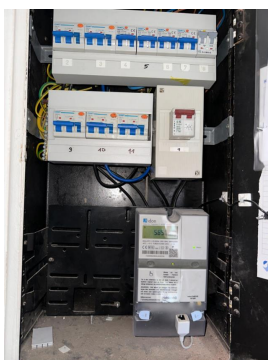
Sikringsskap med automatsikringer.
