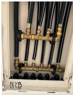
Rørfordelerskap plassert i tak over dusjonen på badetrom.
