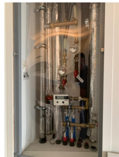
Rørfordelerskap med stoppekran og vanmåler plassert bak døren mot stuen.
