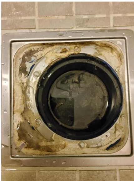
Membran, tettesjikt og overgang til sluk. - [Bad kjeller - Sluk]
