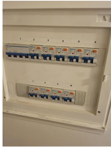
Elektrisk anlegg - [Sikkeringskap]
