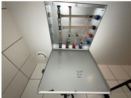
Fordelerskap på badrom.
