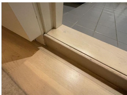
Luftespalte under dørrbladet.
