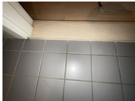
Silikonert i overgangen mellom gulv og dørterskel.
