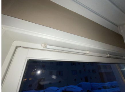
Luftespalte over vindu.
