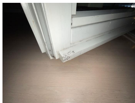
Utside av balkongdør har noe malingsavskalling.
