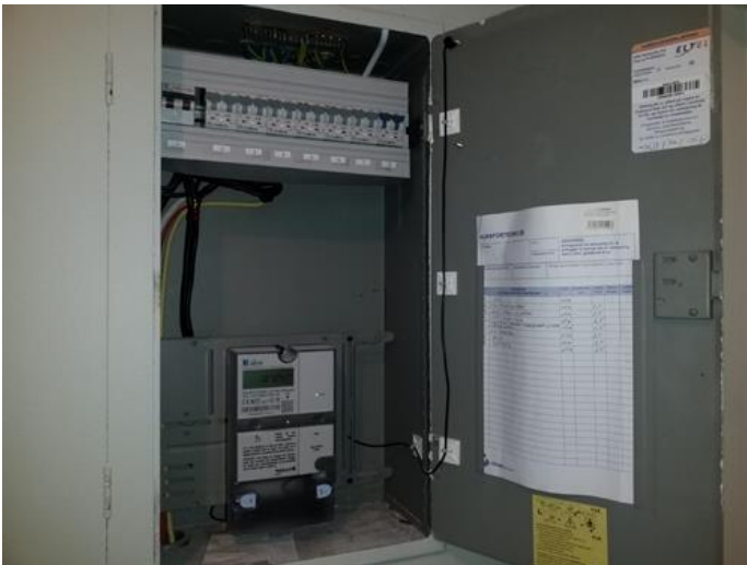
Elektrisk anlegg - [Sikringskap ]
