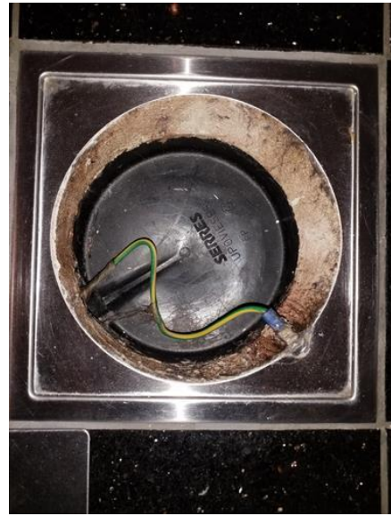
Membran, tettesjikt og overgang til sluk. - [Sluk i dusj]
