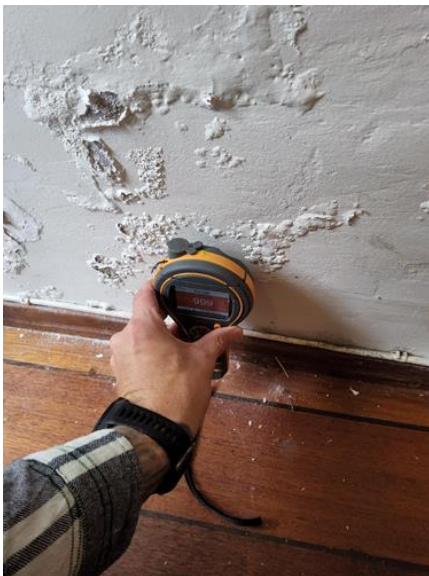
Våtrom - [Saltutslag/avskallinger og forhøyede fuktverdier på skillende vegg fra kjøkken mot bad]
