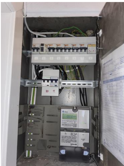
Elektrisk anlegg - [Sikringskap ]
