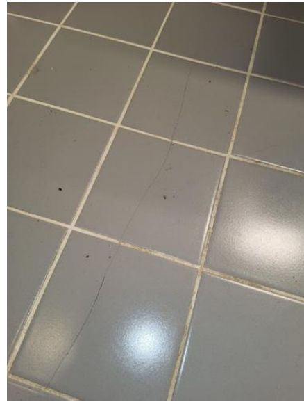
Våtrom - [Riss/sprekker i gulvfliser ]
