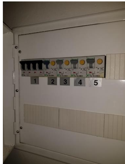
Elektrisk anlegg - [Sikringsskap ]
