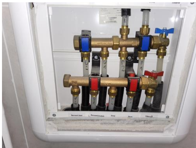
Vannrør - [Fordelerskap bad ]
