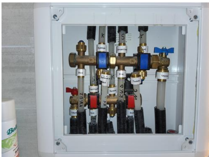
Vannrør - [Fordelerskap bad 2]
