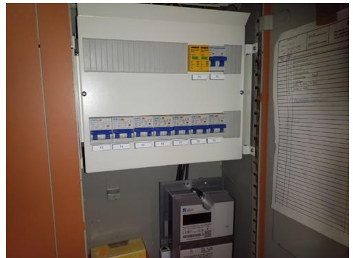
Forenklet vurdering av det elektriske anlegget - [Sikringskap.]
