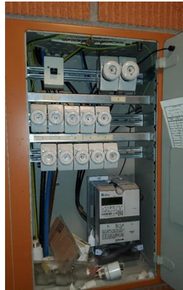
Elektrisk anlegg - [Sikringsskap ]
