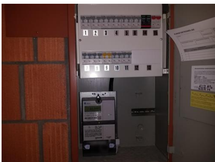
Elektrisk anlegg - [Sikringsskap. ]
