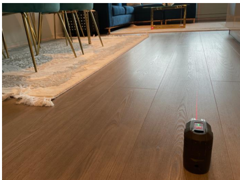
Nivellering stue/kjøkken, avvik ca. 10-20 mm
