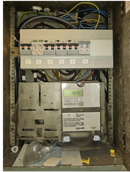
Elektrisk anlegg - [Sikringskap ]
