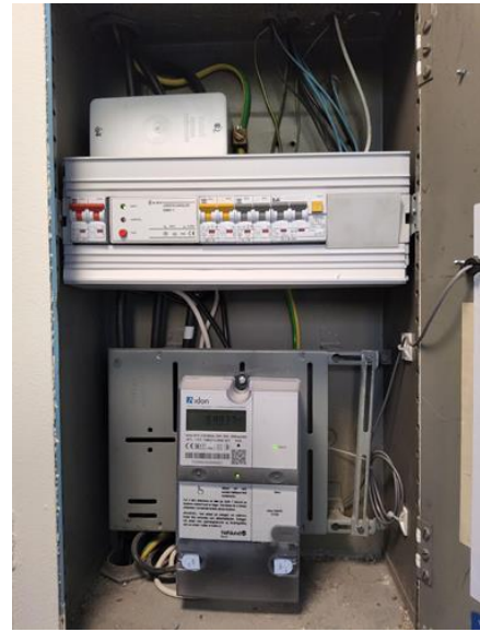
Elektrisk anlegg - [Sikringskap]
