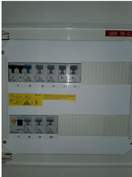
Elektrisk anlegg - [Sikringskap ]
