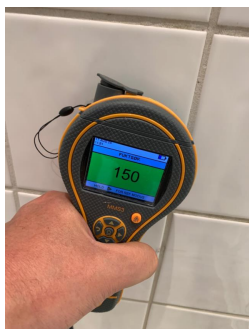
Fuktmåling på badet rom viser normale verdier.
