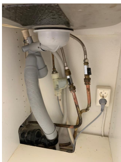
Avløpsrør i underskap vask på kjøkkenet.
