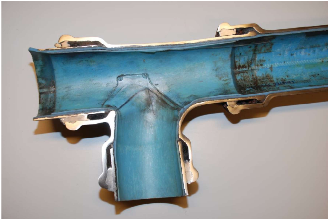
Bildet viser en foring som har sittet 1 år i støpejerns rør.
