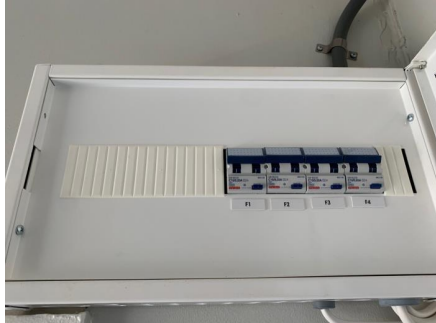
Sikringsskap plassert i entre/gang.
