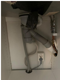
Avløpsrør i underskap vask på kjøkkenet.
