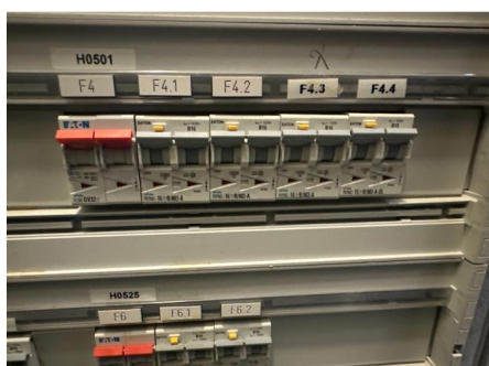
Sikringsskap plassert i rack i felles telecom rom i oppgangen.
