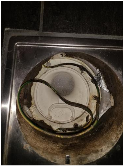
Membran, tettesjikt og overgang til sluk. - [Hovedsluk under servant i bad.]
