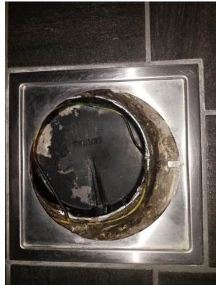
Membran, tettesjikt og overgang til sluk. - [Hjelpesluk i dusjsone.]
