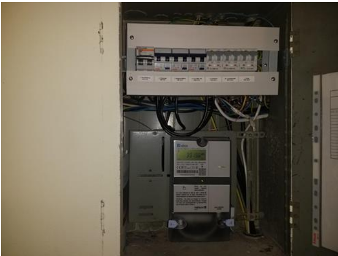
Elektrisk anlegg - [Sikringskap.]
