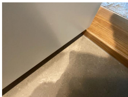
Luftespalte under dørrbladet.
