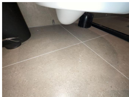
Synlig drensspalte under toalettet.
