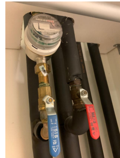
Vannmåler og stoppekran plassert i garderobeskap ved entreen.
