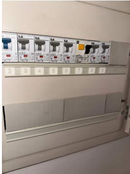
Sikringsskap med automatsikringer.
