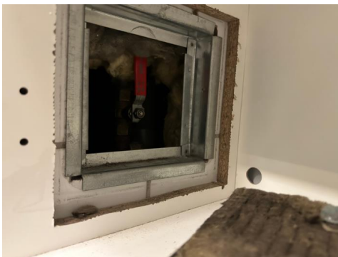
Stoppekraner plassert på bad
