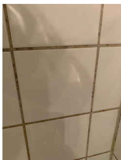
Noe svertesopp i fuger i dusjsonen
