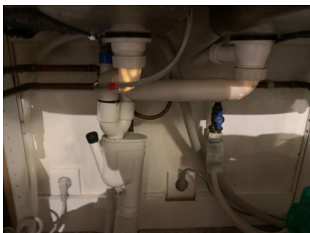
Rørapplegget i kjøkken
