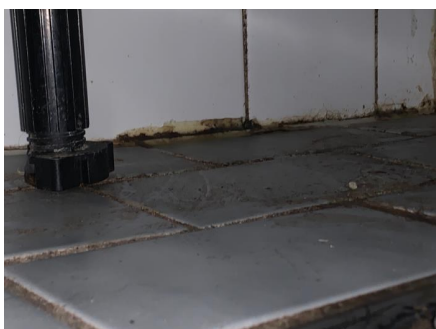
Svertesopp i silikonfuge
