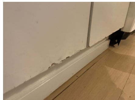
Noe fuktskadete fronter
