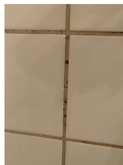
Noe svertesopp i fuger i dusjsonen
