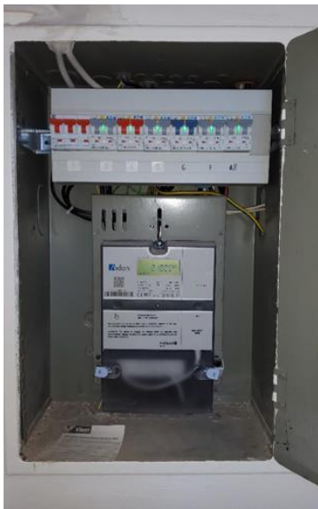
Elektrisk anlegg - [Sikringskap ]
