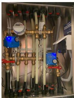
Rørskap. Stoppekraner testet og har tiltenkt funksjon
