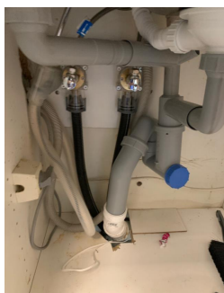
Røropplegget og lekkasje sikringssystem i kjøkkenskap
