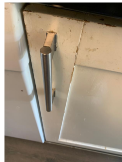
Noe lokale utbedringer bør påregnes
