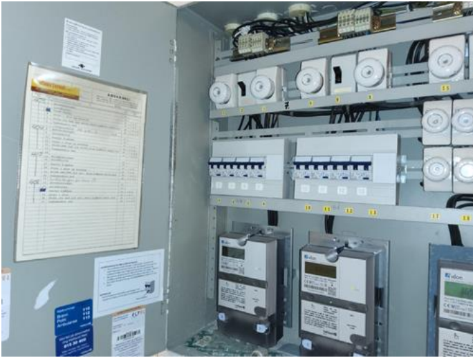
Beskrivelse - [Sikringskap med kursfortegnelse.]
