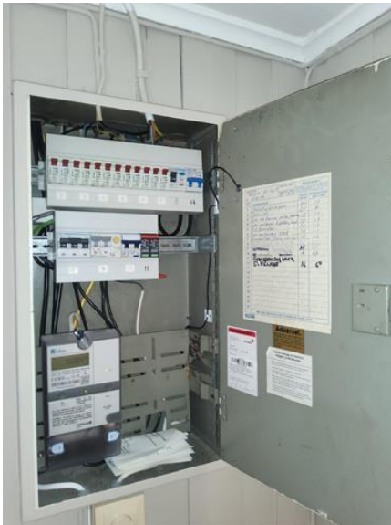
Elektrisk anlegg - [Sikringsskap]
