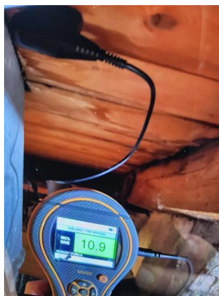
Helhetsvurdering - [Fuktsøk ved gjennomføring yttertak]
