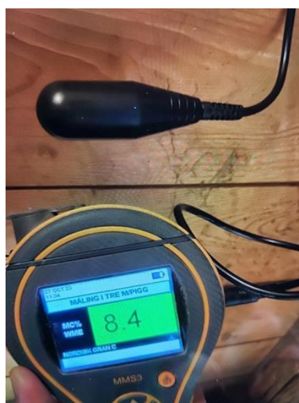
Helhetsvurdering - [Referanse fuktsøk kaldtloft ]
