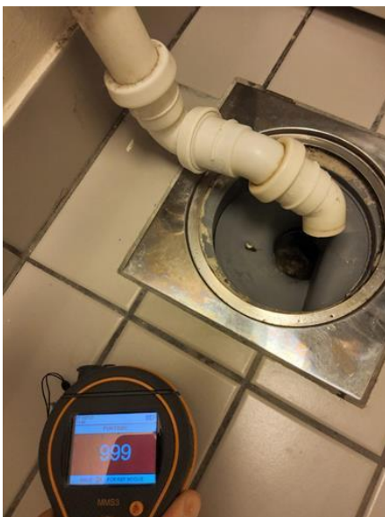
Annet - [Fuktsøk gulv vaskekjeller]
