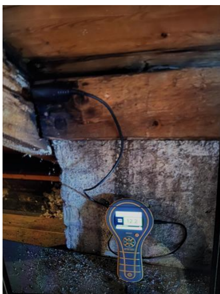
Helhetsvurdering - [Fuktsøk ved skorstein på kaldloft ]
