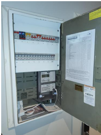
Elektrisk anlegg - [Sikringsskap]
