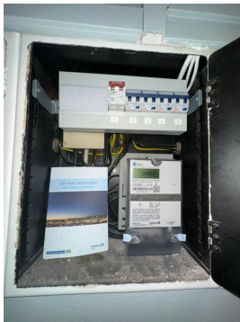
Sikringskap med automatsikringer.
