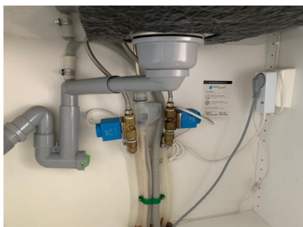
Rørplegget i kjøkken. Waterguard montert.
