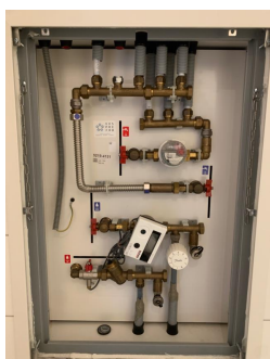
Rørskap. Stoppekraner testet og fungerer som tiltenkt
