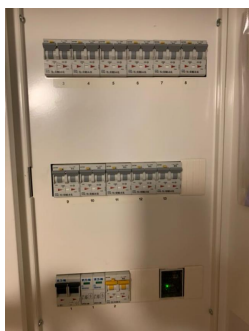
Sikringsskap plassert i bod ved entreen.
