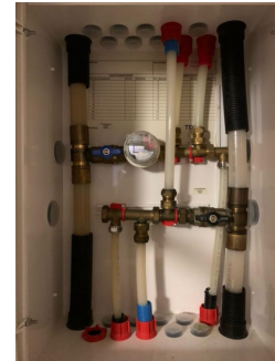
Hovedfordelerskap plassert i bod ved entreen. Vannmåler og hovedstoppekran.
