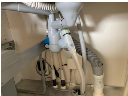
Avløpsrør i underskap vask på kjøkkenet.
