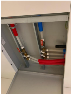
Fordelerskap plassert i tak på bad/vaskerom.
