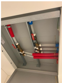
Fordelerskap plassert i tak på baderom.
